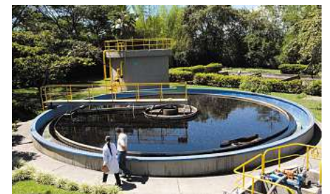
Station d'épuration des eaux usées de notre usine de Bugalagrande (Colombie), l'une de nos 292 stations à l'échelle mondiale.
